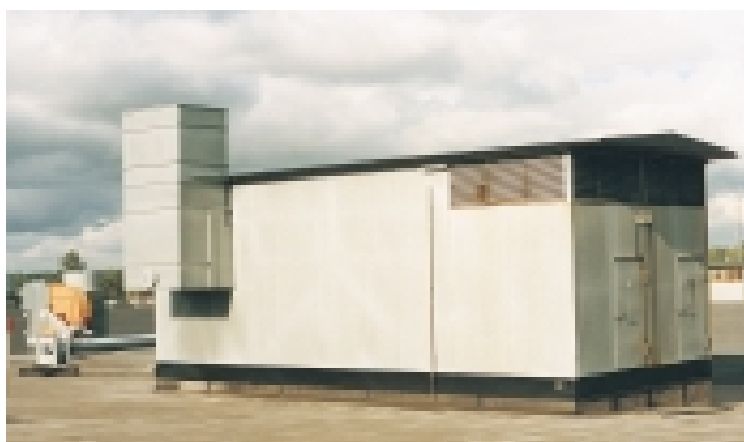
Ett av de stora tilluftsaggregaten för allmänventilation på taket på verkstadsbyggnaden.
