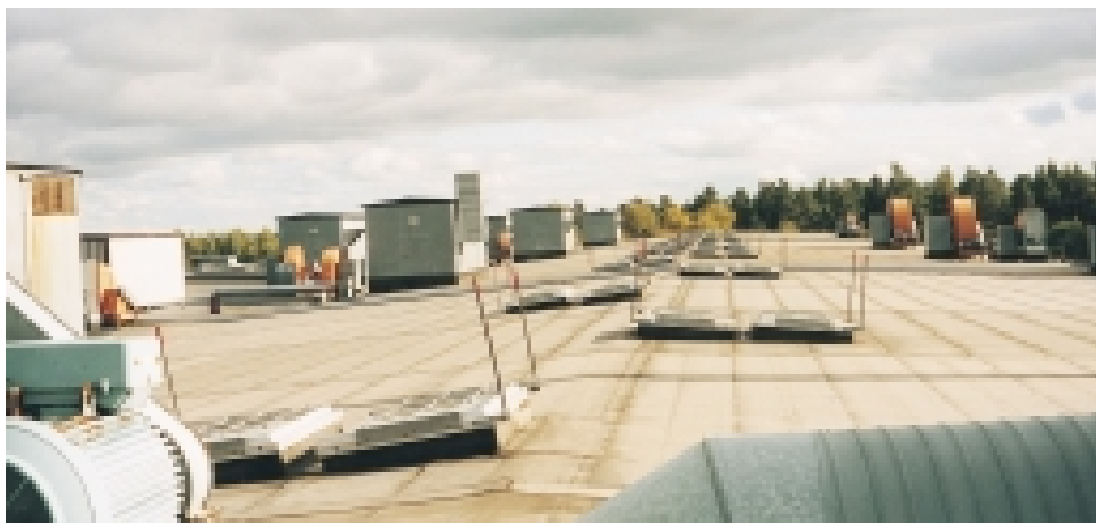
Utsugsfläktar och tilluftsaggregat på taket på verkstadsbyggnaden.
