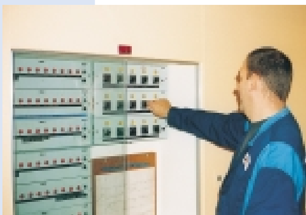
Manuell avstängning av allmänventilation. Låst skåp som inga andra har tillgång till.
