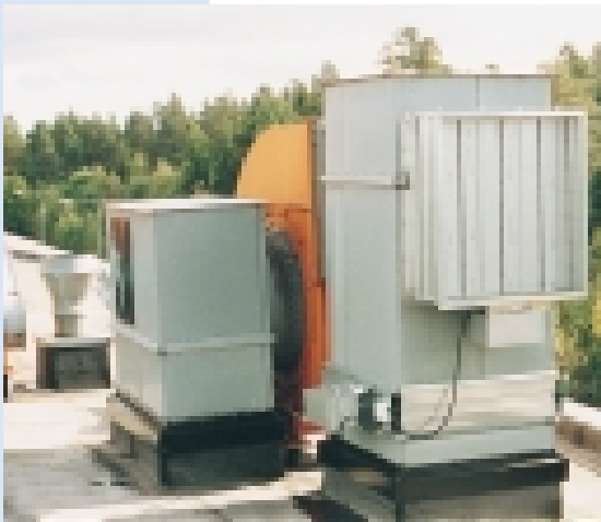
Utsugsfläkt med överkoppling till värmväxlare och tilluftsaggregat. Försett med ett spjäll som öppnas vid övertidsarbete så att stora tilluftsaggregatet inte behöver startas.
